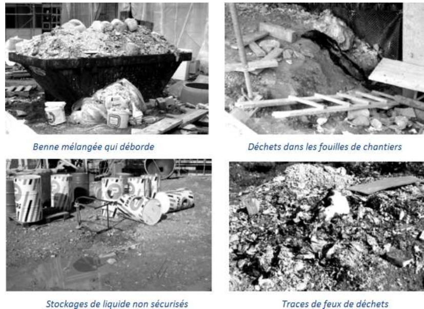
Figure 65 : Exemples de gestions non appropriées des déchets de chantiers
